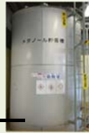
既設メタノールタンク
