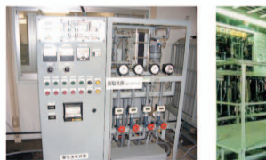
ED膜法浸出水脱塩処理
