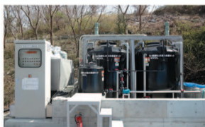
霧状酸化剤注入装置
