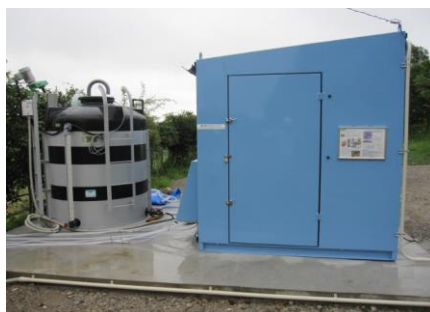
霧状酸化剤注入装置
