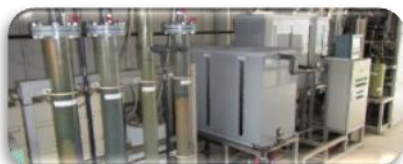
浸出水高度処理実証プラント(RO,ED等) (2001～)
